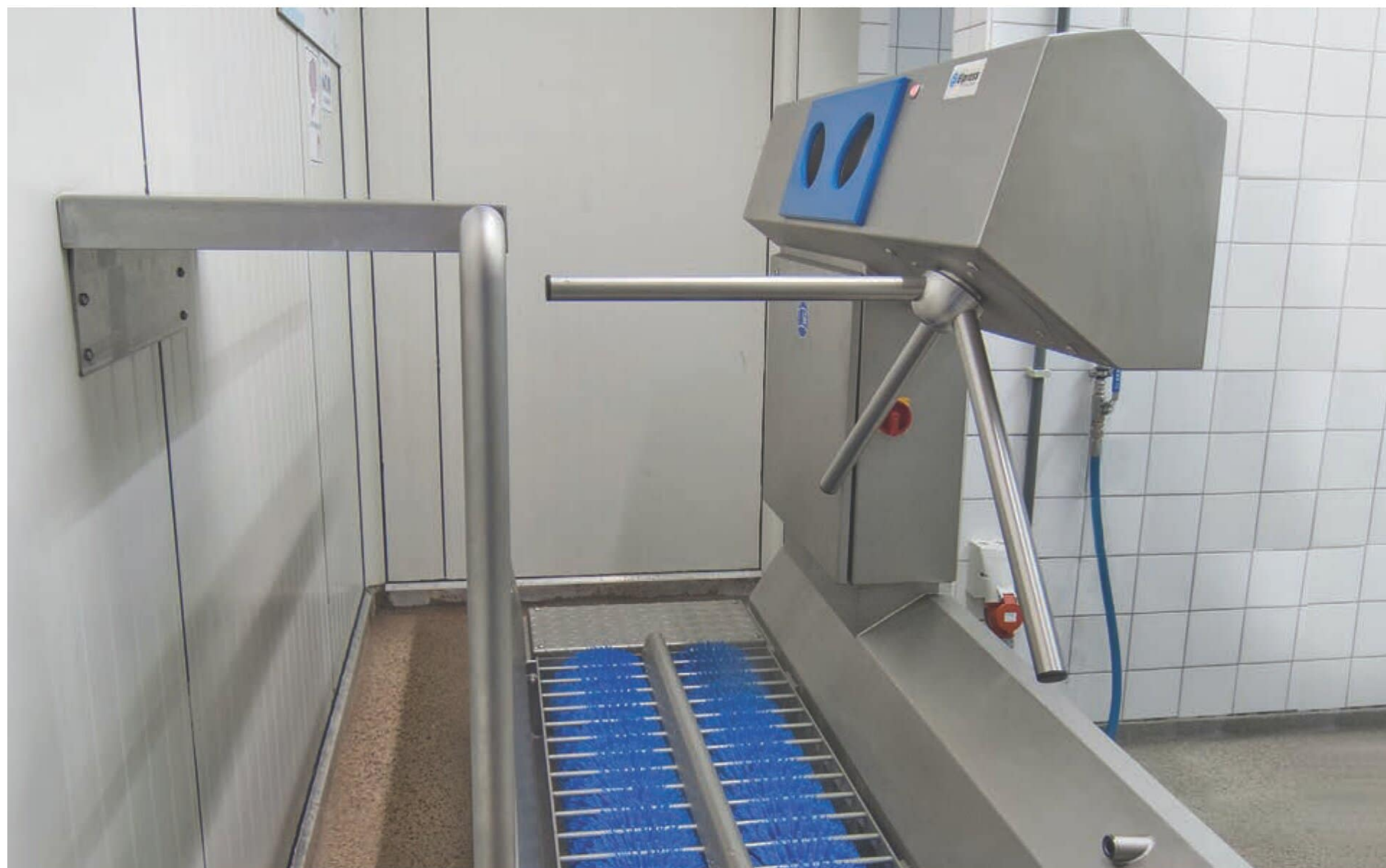
Санпропускник DZW-HDT-1500-L, подключенный к централизованной системе подачи химических реагентов.
